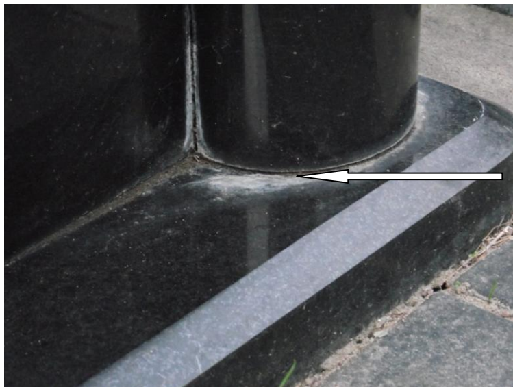
ZANIEDBANY NAGROBEK, KAMIEŃ POZOSTAWIONY PRZEZ WODĘ
